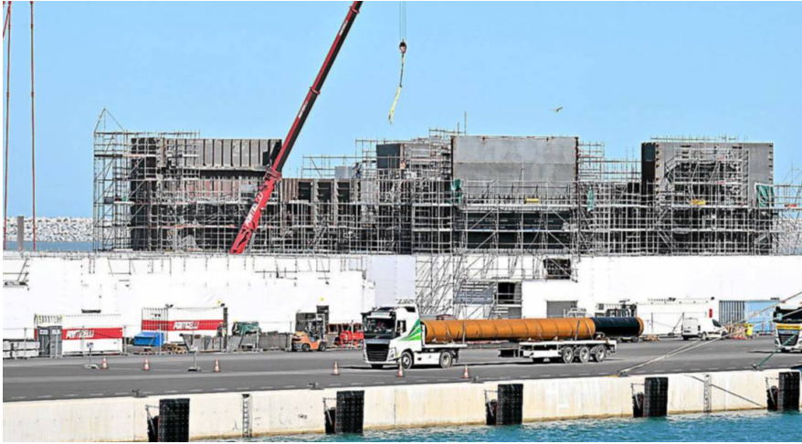
Port-la-Nouvelle : l'un des trois flotteurs prend forme, un carré de 45 m de côté sur lequel sera posée une éolienne du parc pilote EolMed. JIM MART
